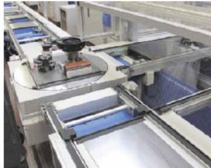
Individuelle und bedarfsgesteuerte Ausschleusung, Durchfahrt oder Weiterleitung zur nächsten Arbeits-/Prozess-/Prüfstation via Wende- und Umlenkstation
